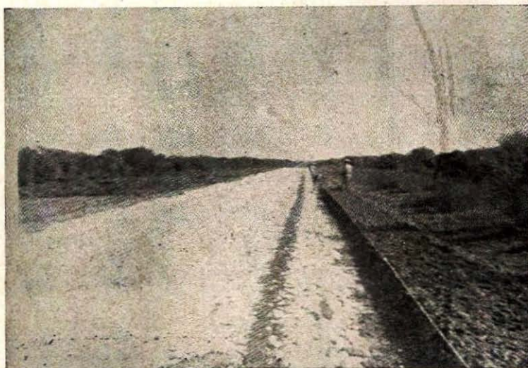
Camino Victoria-Matamoros. Revestimiento en el kilómetro 16.
