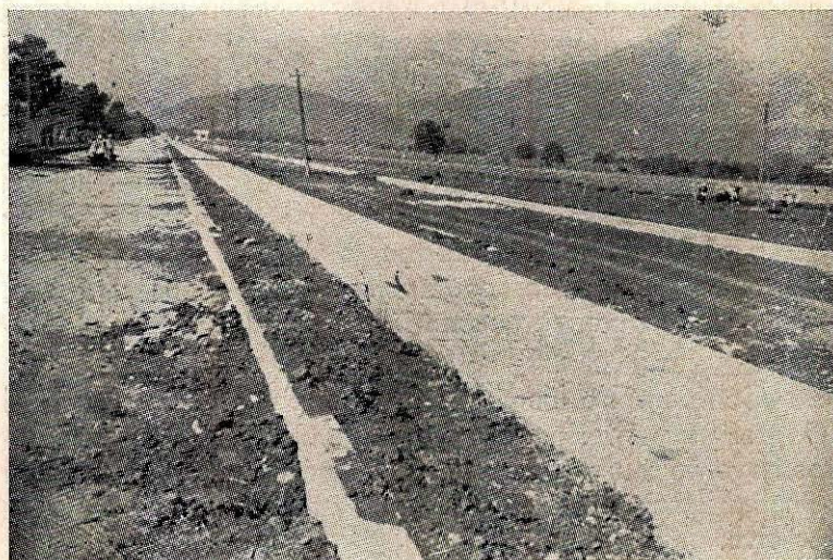
Calzada de Victoria a Tamatlán. Se inicia la obra con el camellón central.
